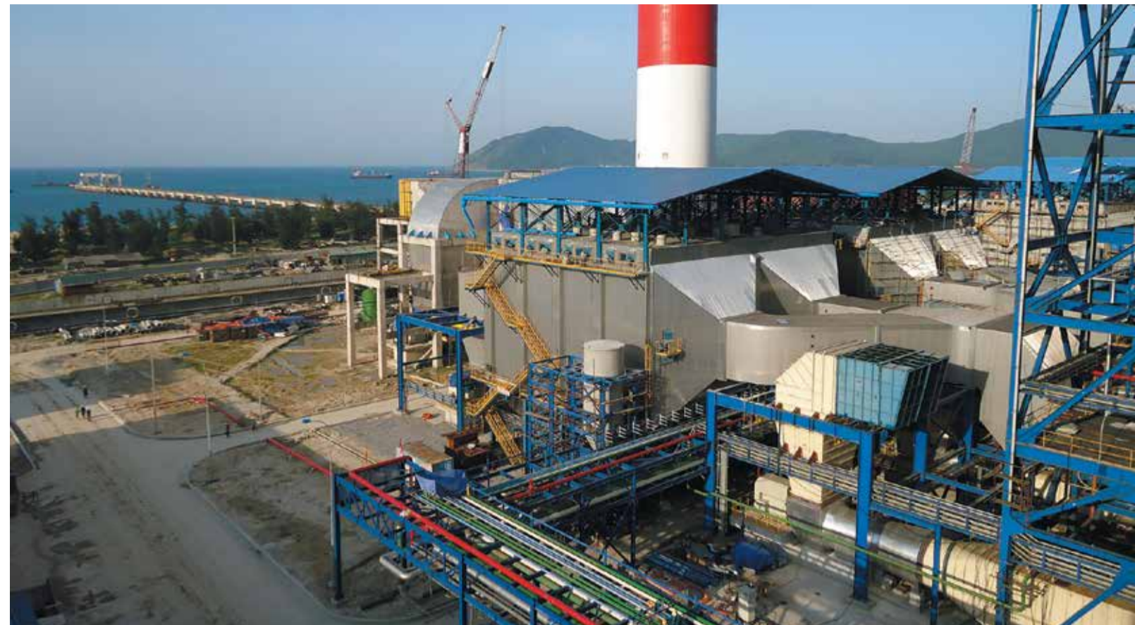
Газоочистная установка электрофильтров на ТЭЦ во Вьетнаме.
